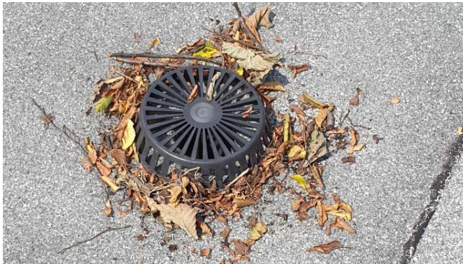
Abb. 20: Mit Laub verschmutzter Dachwassereinlauf
